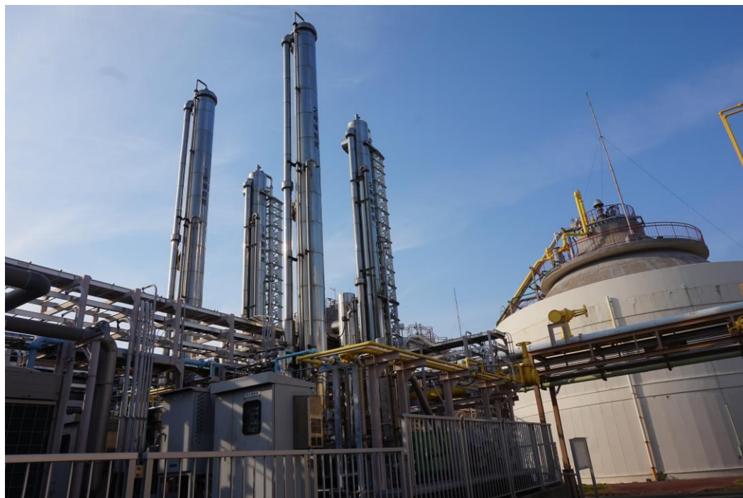
写真 2-5: 下水処理場の消化タンクとバイオガス精製装置(上)、バイオガス発電機(下)
