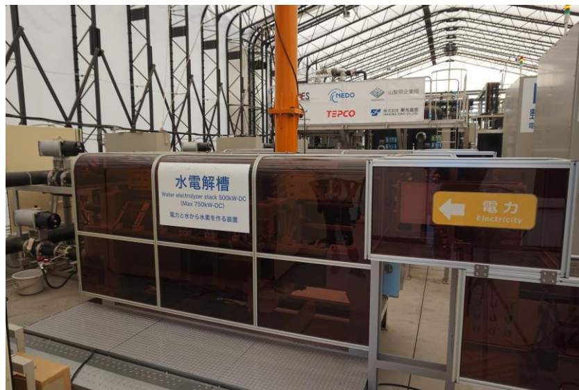
写真 3-1: 山梨県が実証試験中の水電解装置(上)、水素貯蔵タンク(中)、トレーラー(下)
