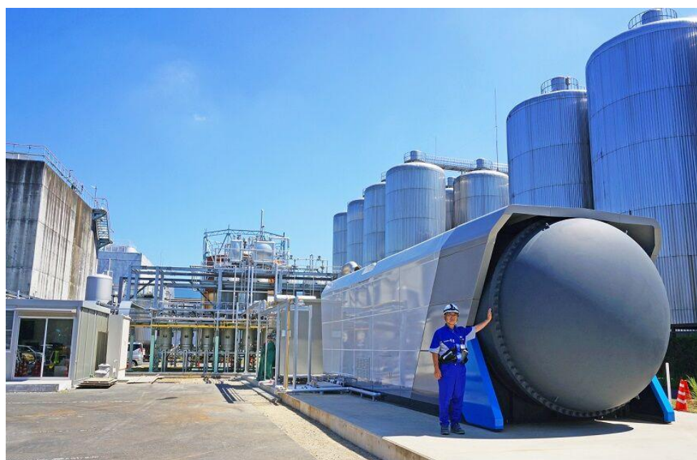
写真 2-2: アサヒビールの茨城工場に導入したバイオガスによる燃料電池
