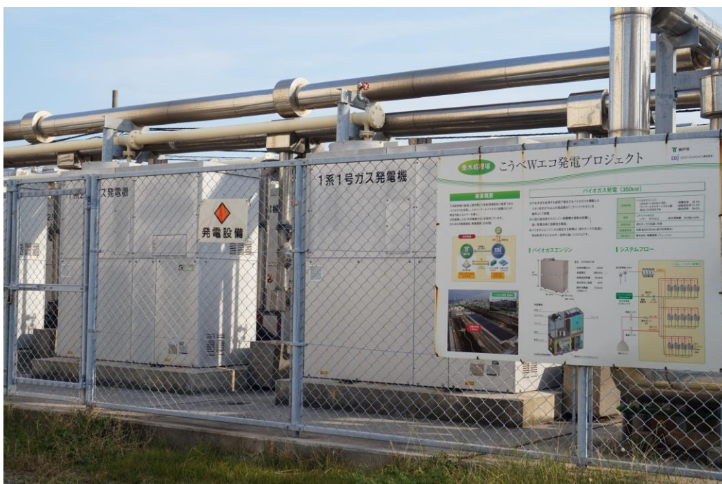
撮影: 自然エネルギー財団(場所: 神戸市垂水処理場)
