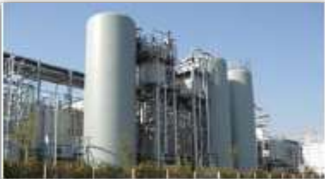
神戸工場バイオガス プラント
