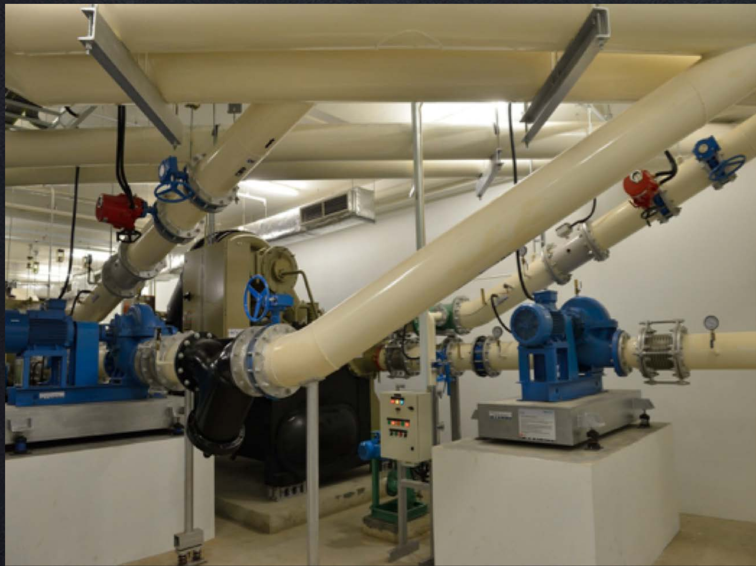
大きいパイプ, 小さいポンプ
